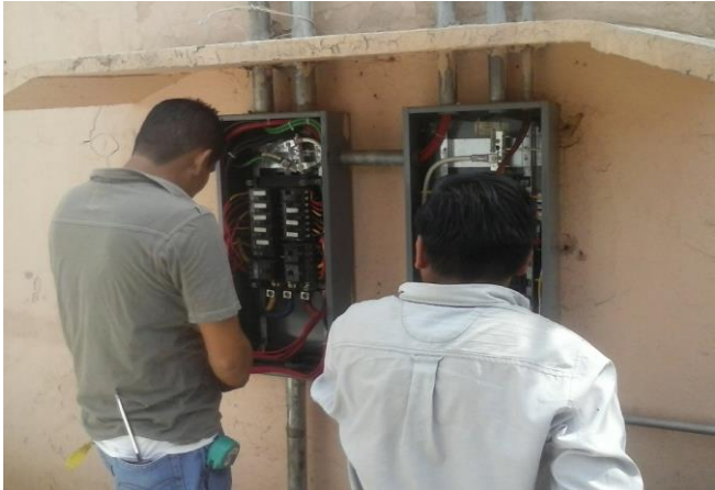
IDENTIFICACION Y MARCADO DE CIRCUITOS EN AREA DE CASETA EN PROCESO
