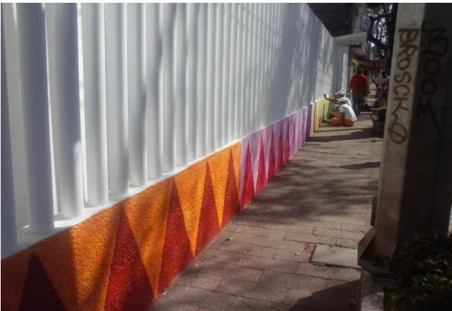
APLICACIÓN DE PINTURA VINILICA EN COLORES EN BARDA DE FACHADA PRINCIPAL FINAL
