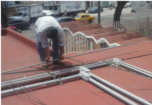
TENDIDO DE TUBERIA CONDULET DE 1 1/2" EN AZOTEA PARA ALIMENTACION DE TABLERO EN CENTRO DE COMPUTO EN PROCESO
