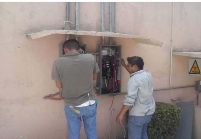
IDENTIFICACION Y MARCADO DE CIRCUITOS EN AREA DE CASETA EN PROCESO
