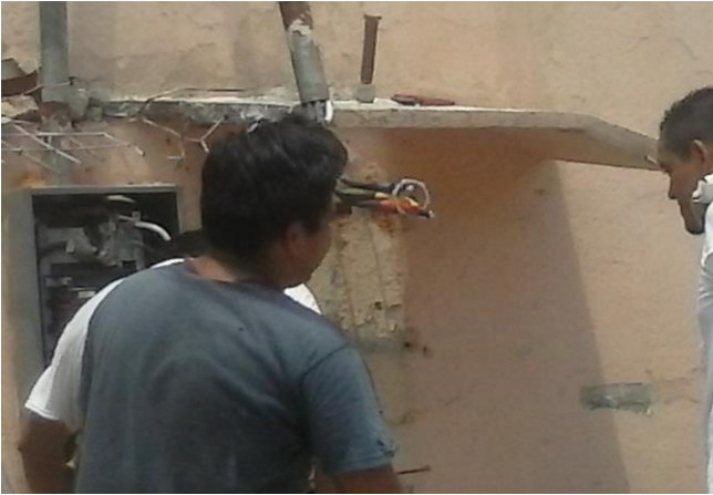
DESMANTELAMIENTO DE TABLEROS TRIFASICOS "A" Y "B" EN AREA DE CASETA DE ALTA TENSION INICIO
