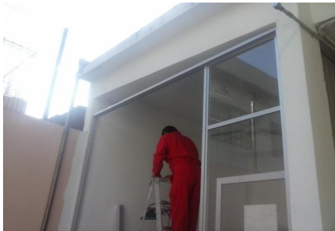
FABRICACION DE VENTANAS DE CANCELERIA DE ALUMINIO EN AREAS DE CONSULTORIO MEDICO Y TRABAJO SOCIAL EN PROCESO
