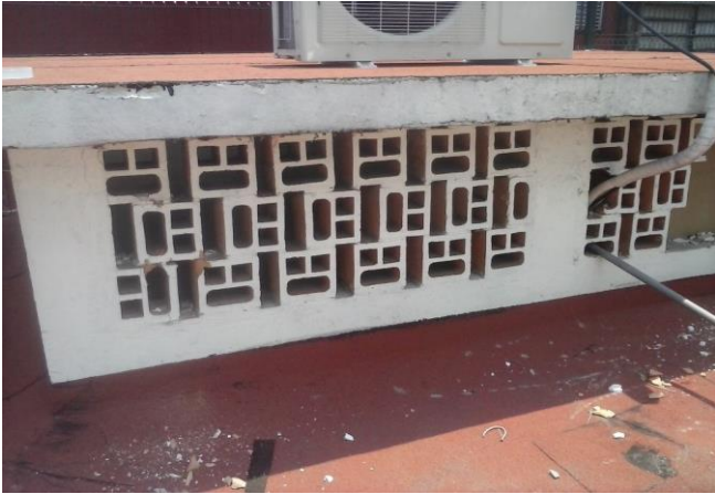
DEMOLICION DE CELOSIA DE BARRO EXTRUIDO EN ILUMINACION CENITAL EN DIRECCION ANTES
