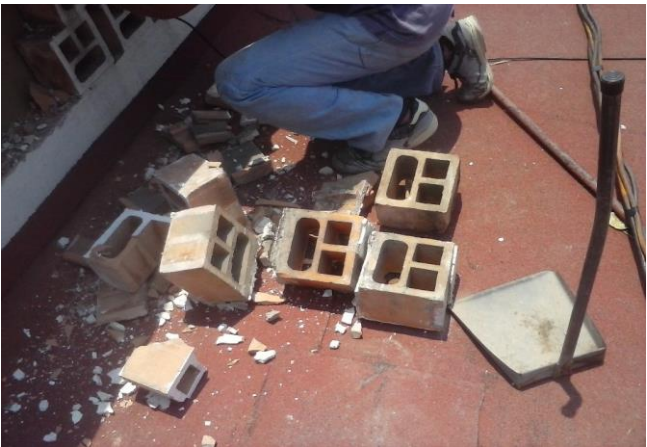
DEMOLICION DE CELOSIA DE BARRO EXTRUIDO EN ILUMINACION CENITAL EN DIRECCION EN PROCESO
