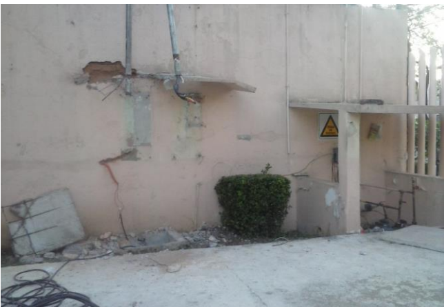
DESMANTELAMIENTO DE TABLEROS TRIFASICOS "A" Y "B" EN AREA DE CASETA DE ALTA TENSION FINAL
