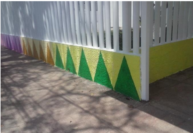
APLICACIÓN DE PINTURA VINILICA EN COLORES EN BARDA DE FACHADA PRINCIPAL EN PROCESO
