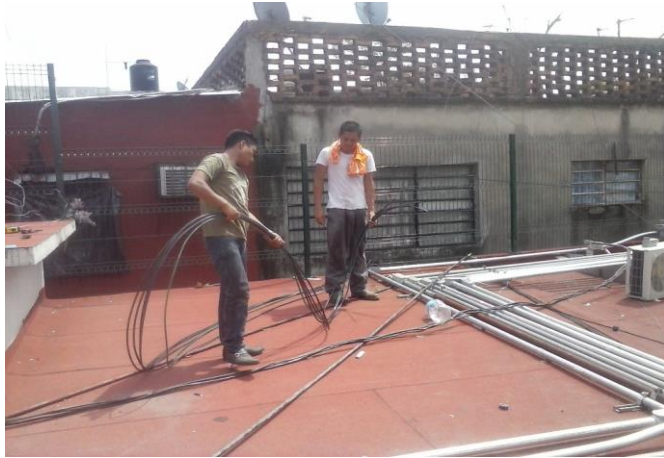
ALIMENTACION ELECTRICA A TABLERO "C" EN AREA DE FILTRO INICIO
